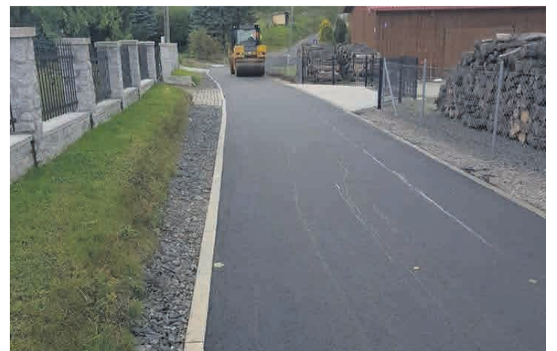
Przebudowa drogi w Chelmcu kol. Jerzyków zrealizowana została dzięki pozyskanej dotacji z budżetu państwa.
