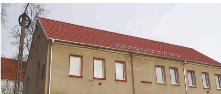
Nowy dach nad świetlicą w Pomocnem zabezpiecza obiekt, w którym mieszkańcy realizują wiele inicjatyw społecznych.
